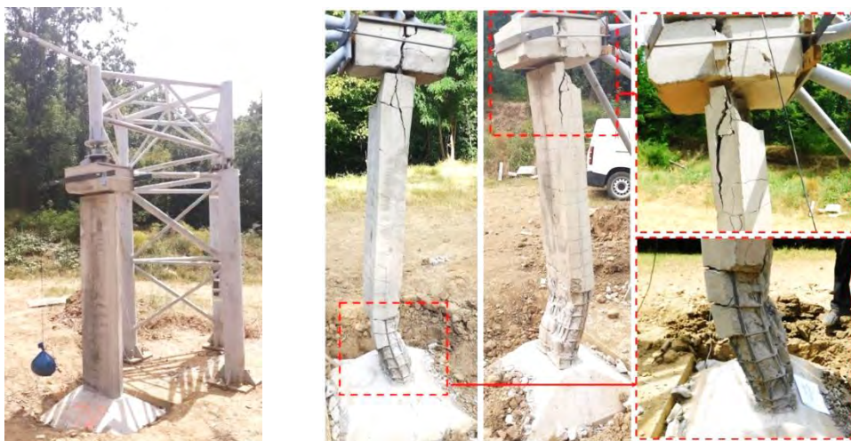
Slika 2. Postav eksperimenta (lijevo) te prikaz opasnog oštećenja stupa (sredina i desno).
